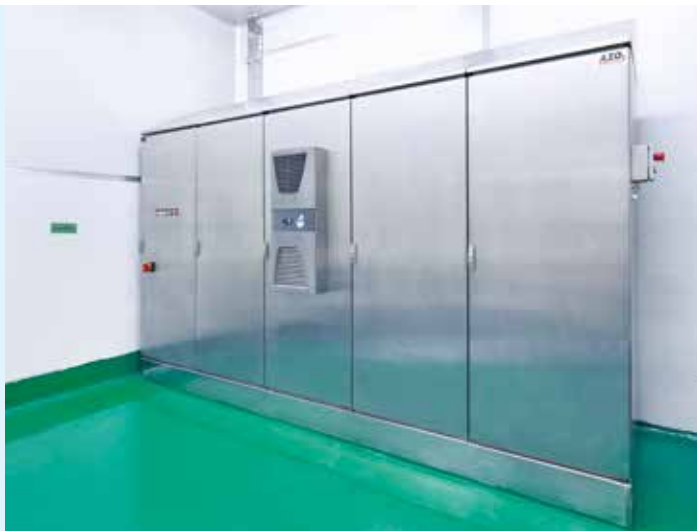
Steuerungstechnik im MCC-Raum (Motor Control Center)
