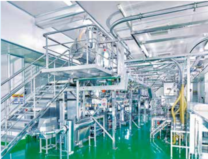
Saubere Produktionsanlage, die alle gesetzlichen Vorgaben sowie die ATEX Richtlinien erfüllt
