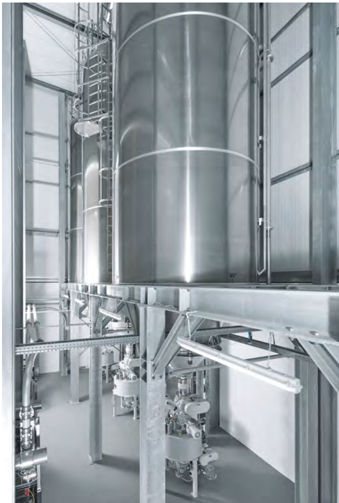
Innensilos für die sichere Lagerung von Mehlen
