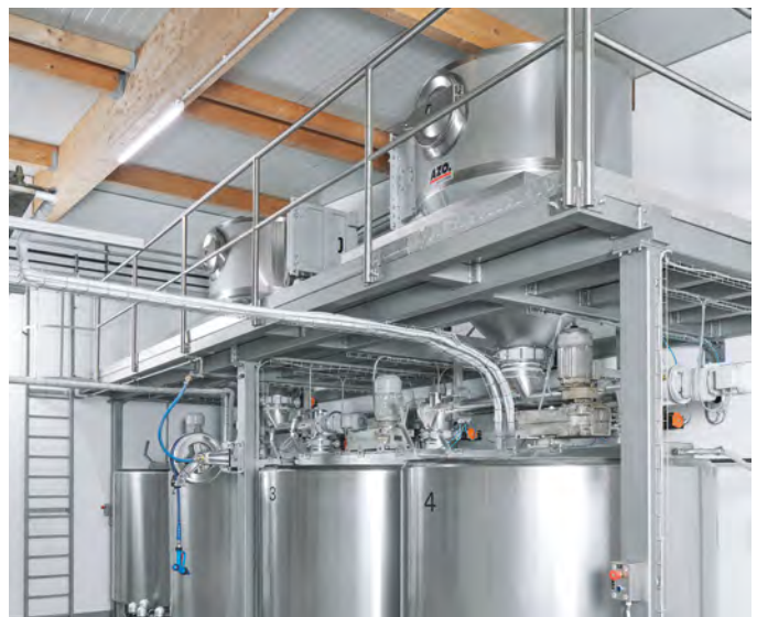
Anbindung von vier Ansatzbehältern an die Mehllieferung
