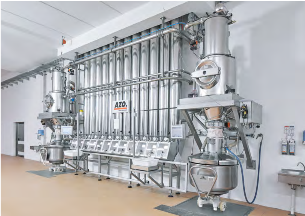
Die Teigmacherei ist das Kernstück der Rohstoffbereitstellung. Hier erfolgt die Beschickung der Knetschalen mit den Großkomponenten sowie die grammgenaue Zusammenstellung der Handzutaten.
