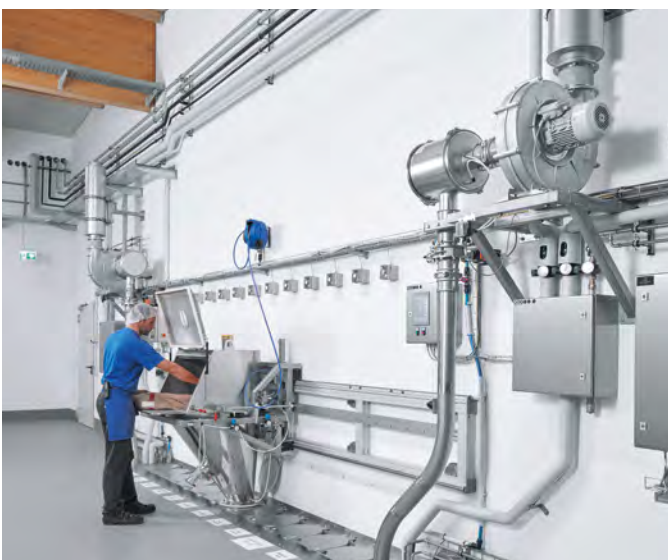
Befüllen der Pufferbehälter über einen verfahrbaren Einfülltrichter vom „Schüttboden“ aus
