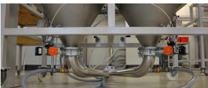
Aufgabeschuhe und Zusammenführung in eine Förderleitung
