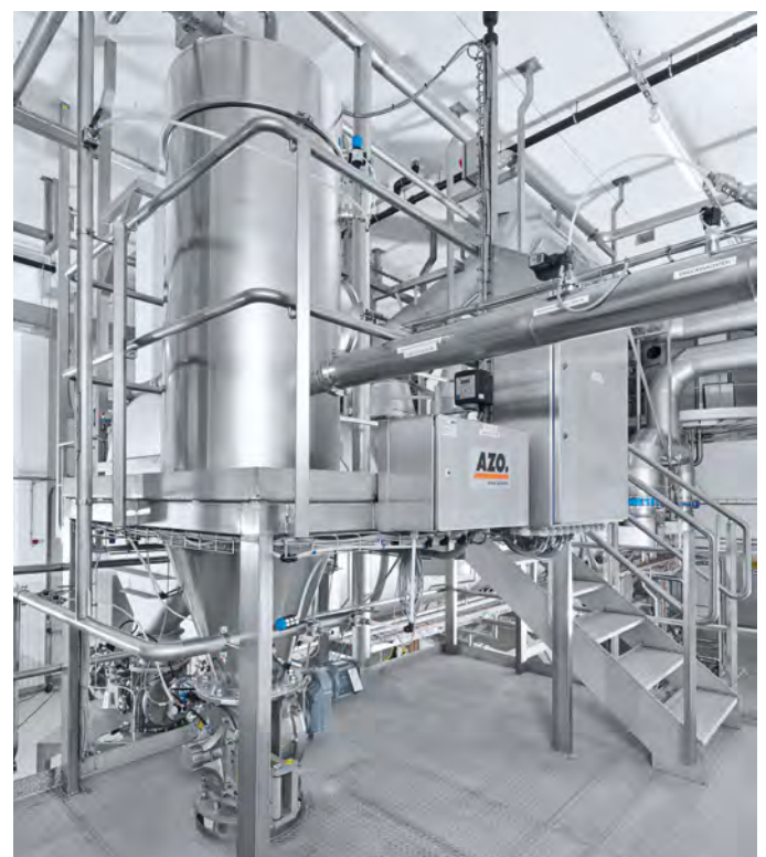
Abscheider mit nachgeschalteter Schleuse zur kontinuierlichen Förderung
