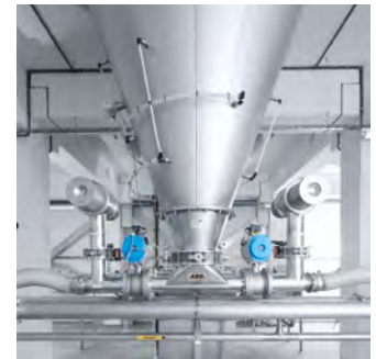
Produktaufgabe in zwei Förderleitungen
