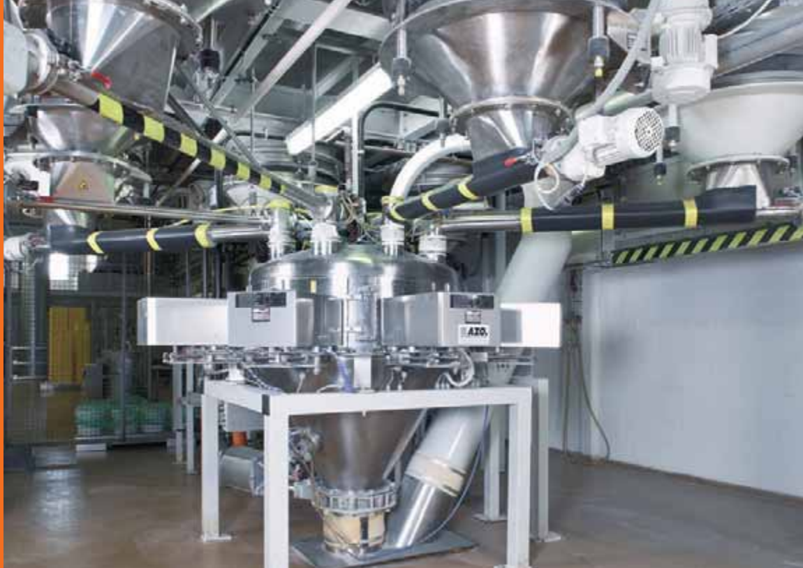
AZO COMPONENTER®, kreisförmig im klimatisierten Bereich
