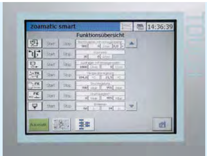
Automatischer Ablauf aber auch manuelle Bedienung sind möglich
